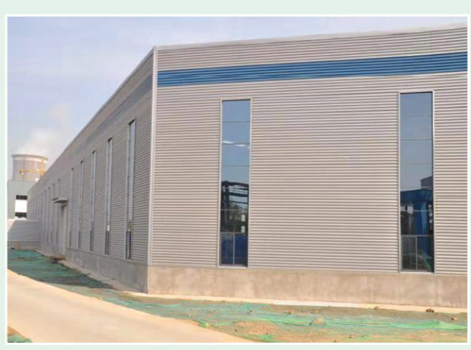
河南远大玻璃有限公司年产40万平方米智能化玻璃生产项目,占地23.61亩,新建标准化厂房2.3万平方米。目前主体已完工,正在安装设备,进行室外配套工程施工。(记者 雷霄)
