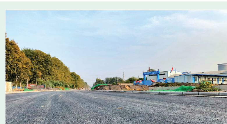
新安西路改建工程东起货站路,西至昆仑路,全长1609米,总投资5500万元,是国际陆港第二节点的一条主要物流通道,也是我区重点项目之一。目前,项目南半幅已建成通车,预计10月下旬北半幅开工建设。(记者 崔玉琳)
