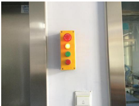
控制室内急停开关
