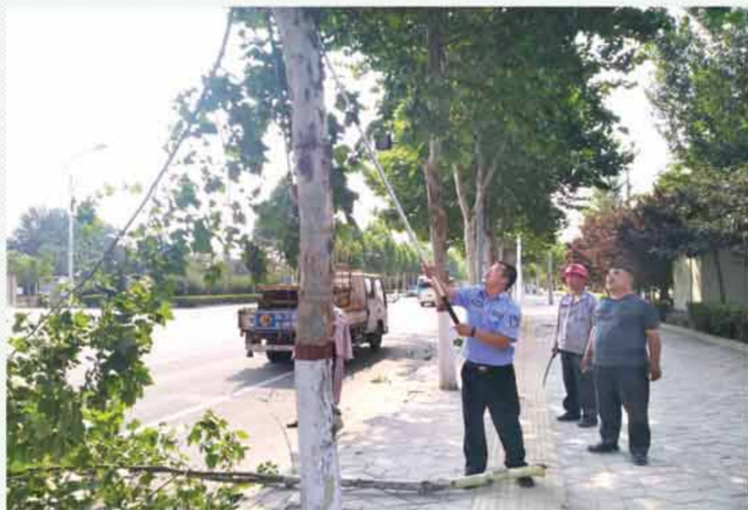
近日,区交巡警加强对辖区路段监控、信号灯、标识标牌被树木遮挡的情况排查,并联合区绿化队修剪了树枝,使被遮挡的标识标牌重新“亮”起来。 (通讯员 张锐)
